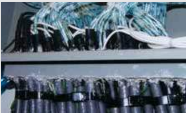
制御盤ケーブル結束 (NOR·NON)
