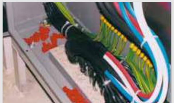
制御盤ケーブル結束 (NOR·NON)
