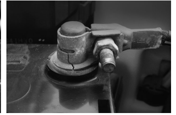
亀裂が入ったターミナル
